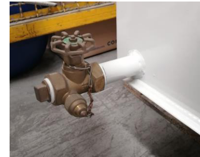
<<< Válvula de Drenaje
